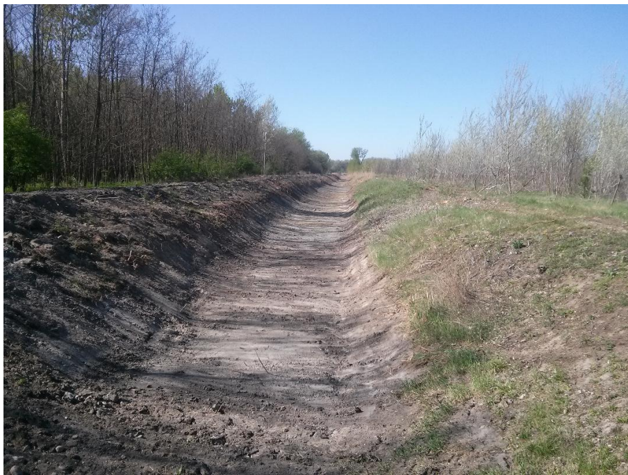
Prilog 5.: Neopravdano izdubljen glavni kanal na teritoriji Bodoglar. Stav nadležnih u oblasti vodoprivrede, rezultira oštećenje vodene baze od suštinskog značaja za poljoprivredu i šumarstvo.
