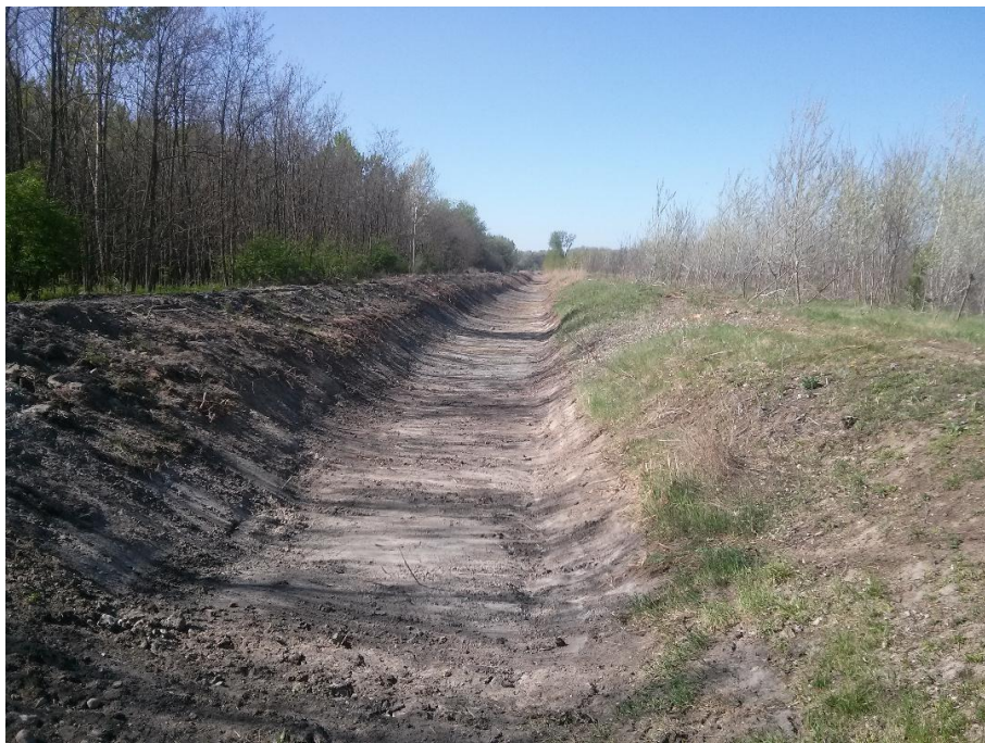
5. ábra: Indokolatlanul kimélyített főcsatorna Bodoglár térségében. A vízügyi hatóság hozzáállása a mezőgazdaság és erdészet számára is elengedhetetlen vízbázis károsítását eredményezi.
